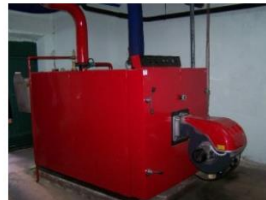
Caldera de gas natural
