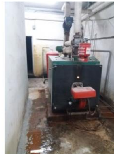
Caldera de gasoil
